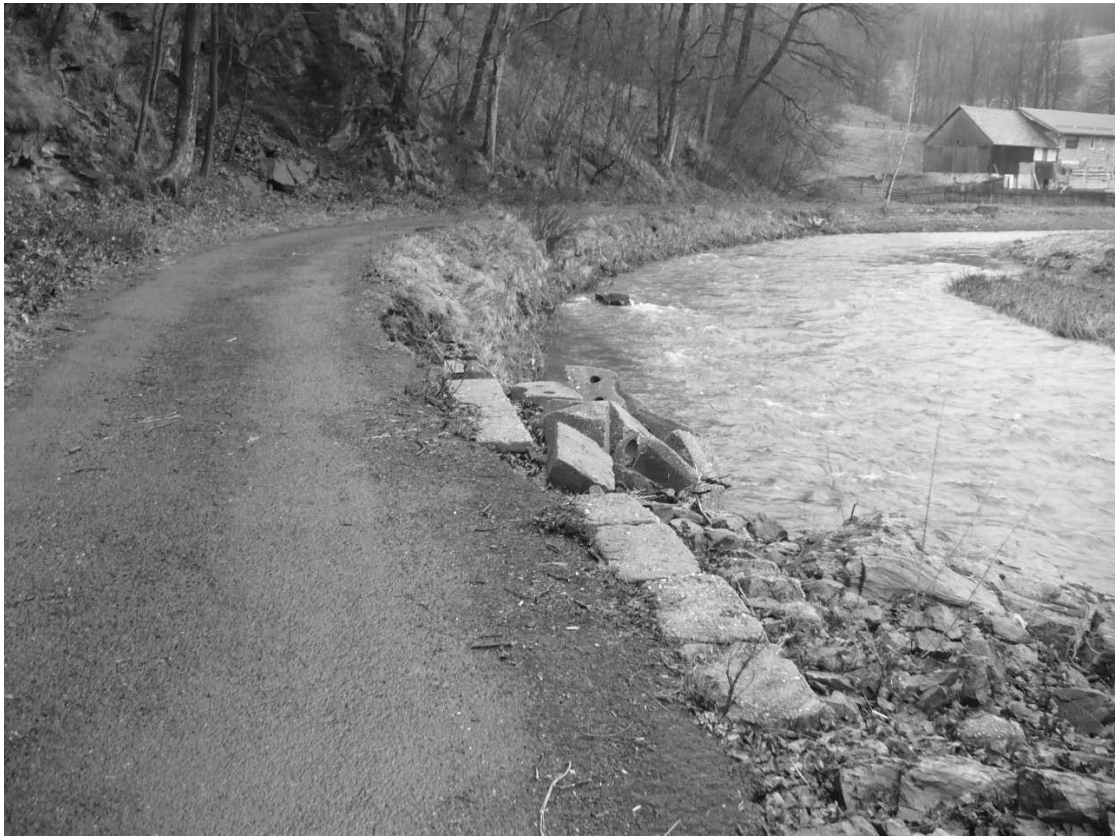
Fot.2 Droga nr 114459 D Podmyta skarpa drogi
