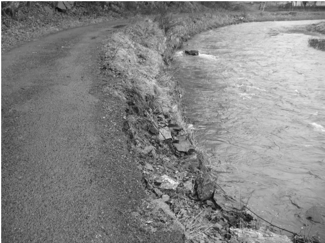
Fot.3 Droga nr 114459 D Podmyta skarpa drogi
