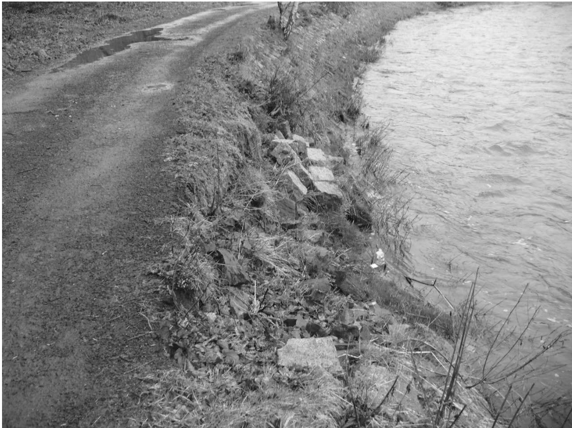
Fot.4 Droga nr 114459 D Podmyta skarpa drogi
