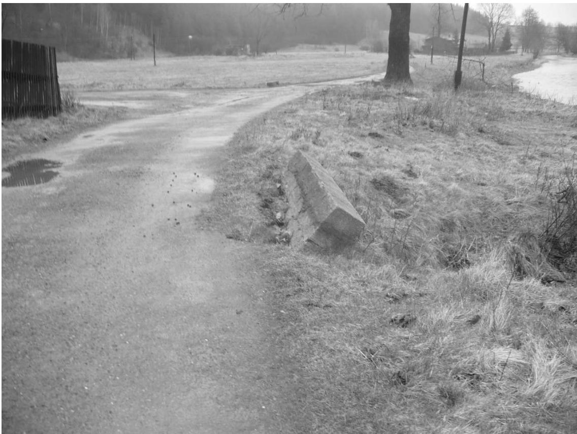
Fot.5 Droga nr 114459 D Uszkodzona ścianka czołowa przepustu
